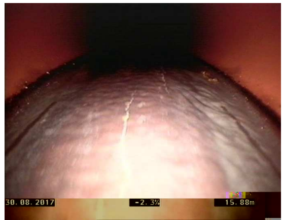
Fissures et affaissement
