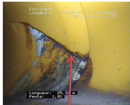
Cassure et infiltration
