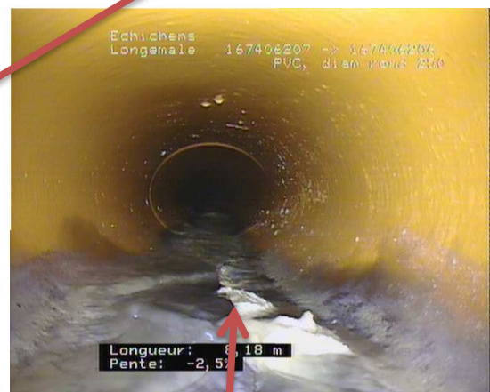
Fissure au radier et déformation
