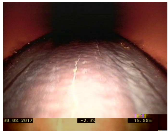
Fissures et affaissement
